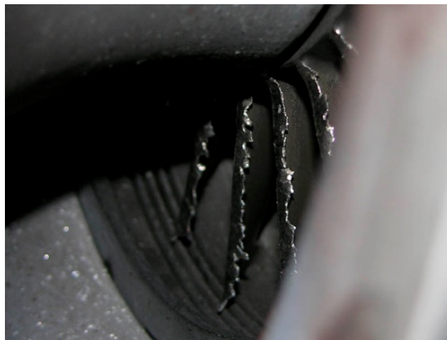
Fig. 3 Damaged fan blades
